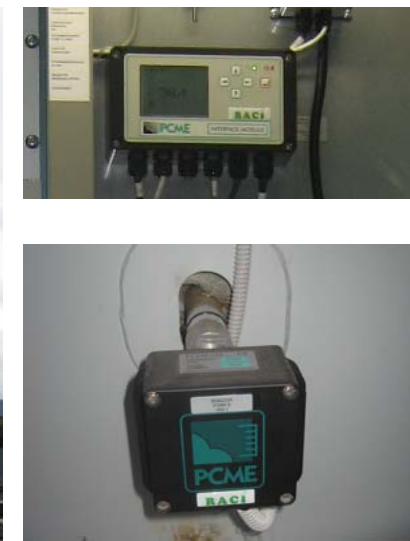
BHKW Sulzbach-Rosenberg Nemčija PCME DT 990S
