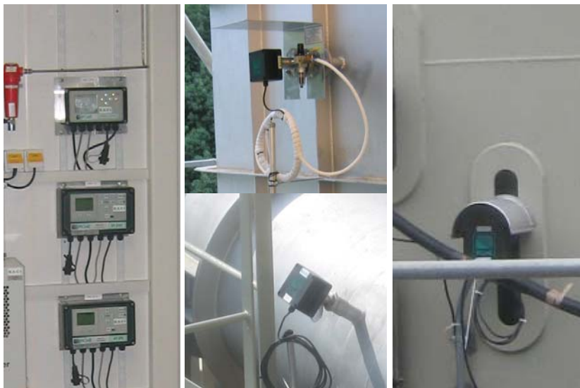
LAFARGE Trbovlje, Cementarna mlin premoga: PCME DT 270; pred razžveplalno napravo: PCME SC 602 novi dimnik: PCME DT 270T
